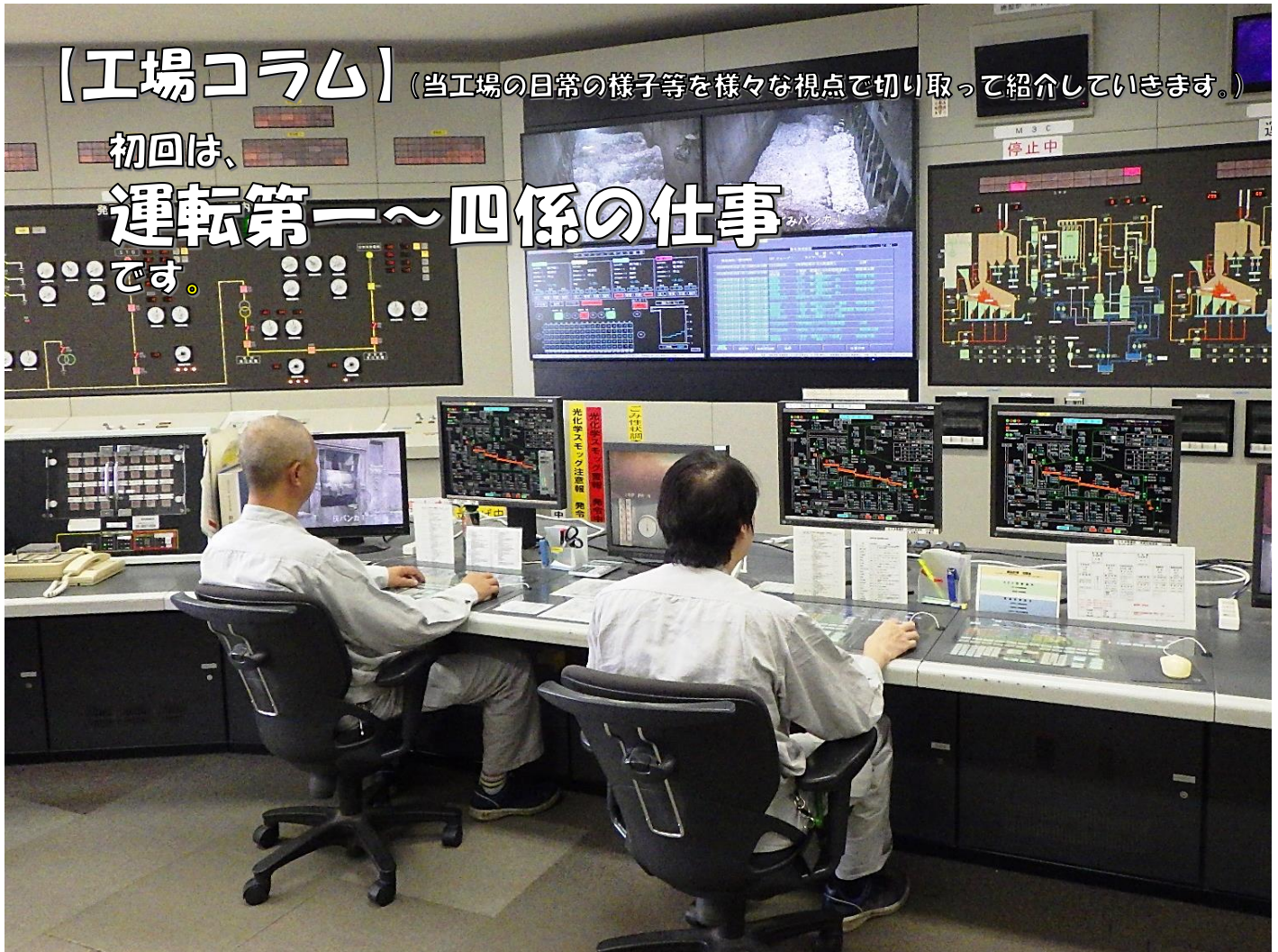
中央制御室において24時間365日焼却炉の監視や機器類の操作を行っています
